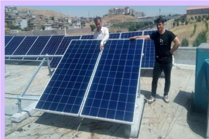
نصب و راه اندازی سامانه انرژی خورشیدی در دانشگاه گروه فنی و مهندسی
